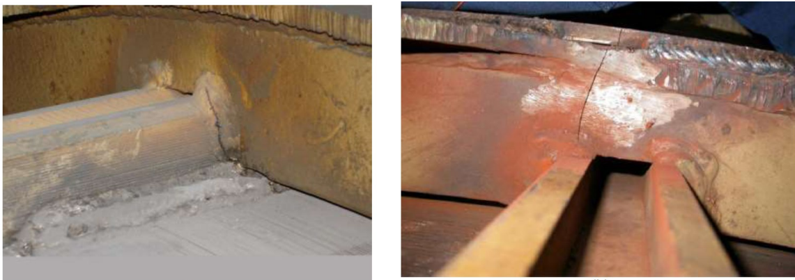
Рис. 5. Примеры повреждения элементов крепления сердечника к корпусу турбогенераторов серии ТГВ-300
